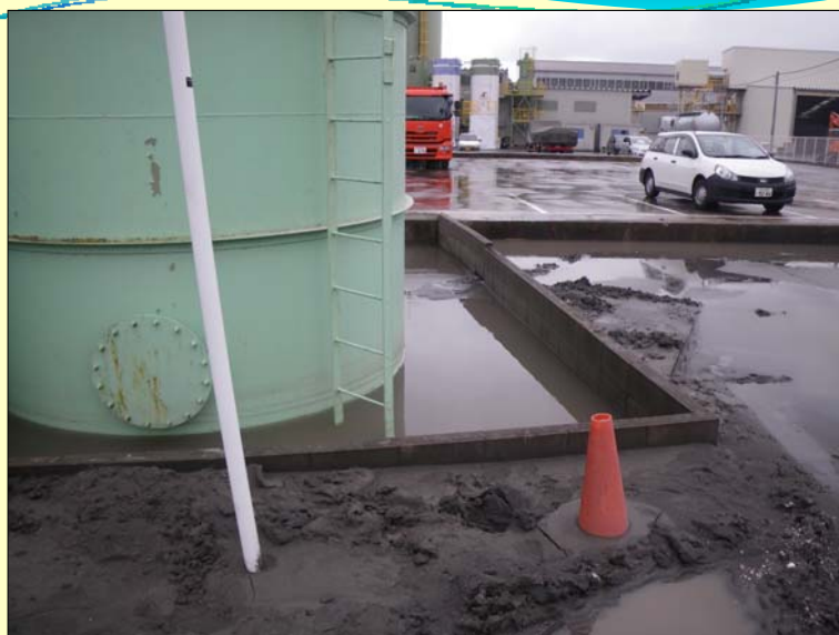
噴砂状況(千葉県市川市)
